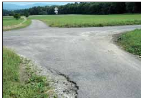
Das Wegnetz im Bürgerland «Allmend» leidet unter der intensiven Bearbeitung mit schweren Maschinen und muss früher oder später saniert werden. (Bild: mh)
