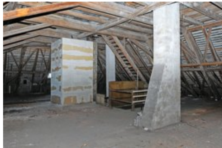
Der Dachstock erhält eine Zwischendämmung und kann künftig für Anlässe genutzt werden. Der Abluftschacht für die Küche (hinten) kommt weg.
