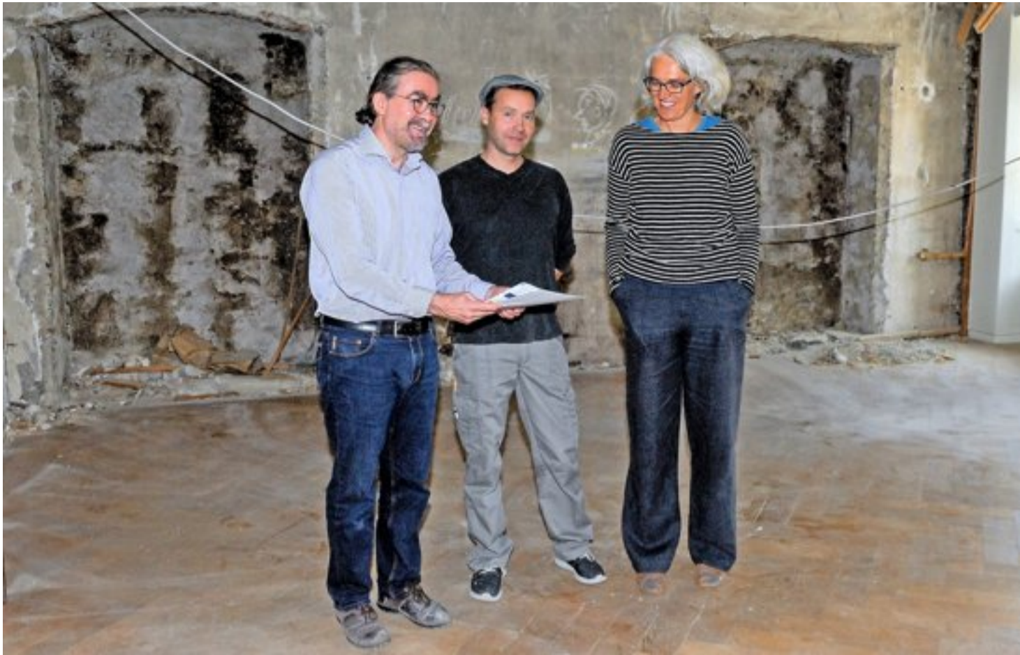
Auf einem Rundgang durch das Gästehaus Kreuz: (v.l.) Architekt Christoph Grütter, Restaurator Patrick Dietz und Denkmalpflegerin Dominique Plüss. Hier im sogenannten Meitlichämmerli kamen zwei alte Nischen zum Vorschein.
